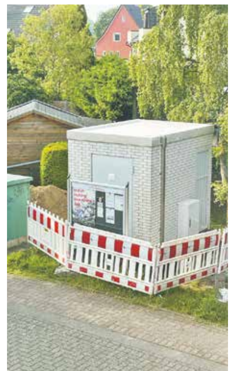
Das Verteilerhaus steht. Broich wird an das Glasfasernetz angeschlossen.
